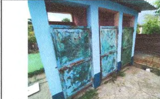
FOTO 8: Sustrucción de puerta en servicios sanitarios
